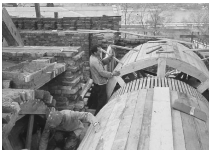
Fot. 6. Poważny błąd: sklepienia w zamku zakładano, gdy nie było jeszcze dachu (fot. J. Tajchman)
