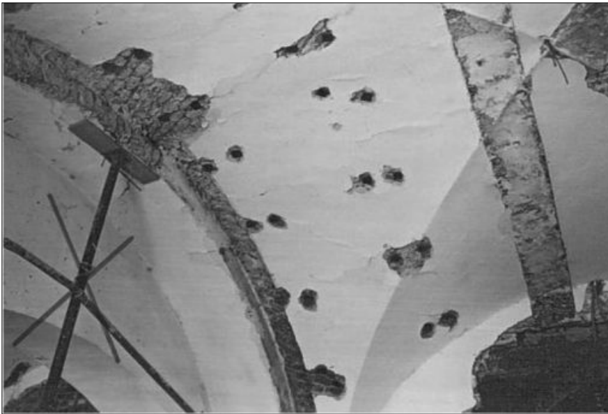
Fot. 13. Lublin, Rynek 5 – sklepienie w muzeum, wypróznione pachy. Sklepienie zaczęło pękać, więc wprowadzono nad nim belkę, do której podwieszono sklepienie. Sklepienia nie wolno podpierać punktowo (co widać na zdjęciu) – jest to błąd (fot. J. Tajchman)
