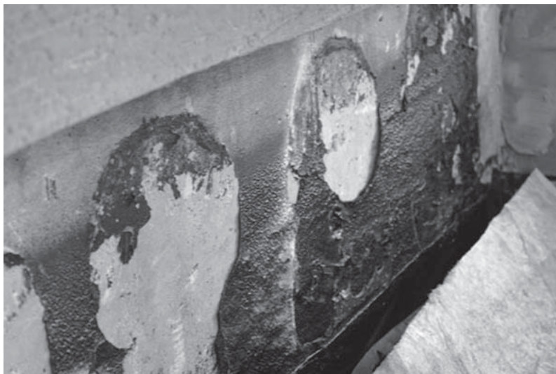
Rys. 4.4. Brak przyczepności powłoki do podłoża spowodowany m.in. brakiem gruntowania podłoża, co jest widoczne w rejonie odspojień [20]
