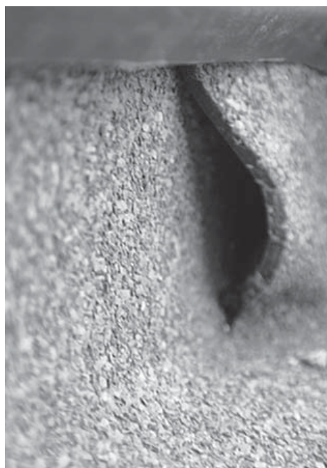
Rys. 4.5. Nieprawidłowo sklejonny zakład podłużny papy przyczyną wnikania wody pod warstwę hydroizolacyjną [20]
